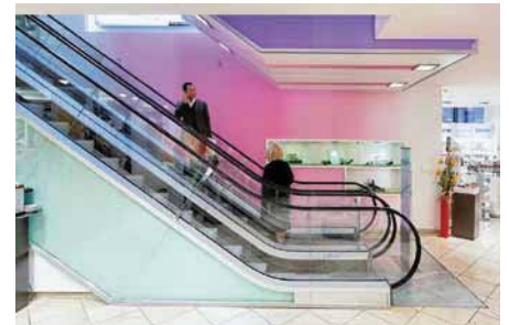
LED-Installation an der Rolltreppe im Douglas Megastore in München.
